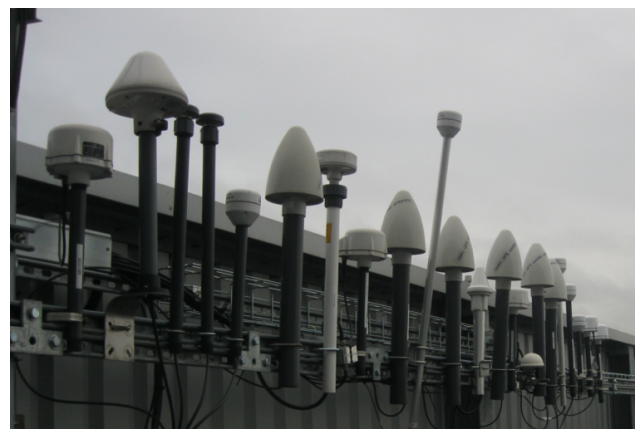
rys. 26 Przykład wadliwej instalacji: odbiorniki zamontowane zbyt blisko siebie zakłócają się wzajemnie i dołączone są do instalacji odgromowych
